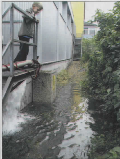
800 Liter Wasser pro Minute ergossen sich in den Hang hinter dem Gymnastikraum, dessen Wand das Wasser stellenweise durchließ. ■ Foto: G. Günther
